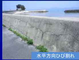
水平方向ひび割れ
