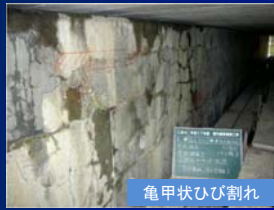
亀甲状ひび割れ
