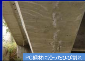
PC鋼材に沿ったひび割れ
