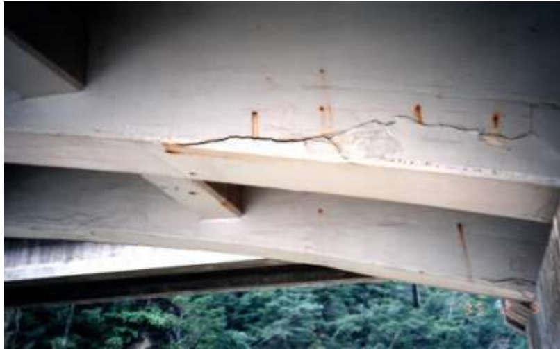
劣化によるひび割れ発生
