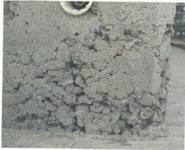
解説 図 7.3.11 柱部下端のジャンカの発生状況
