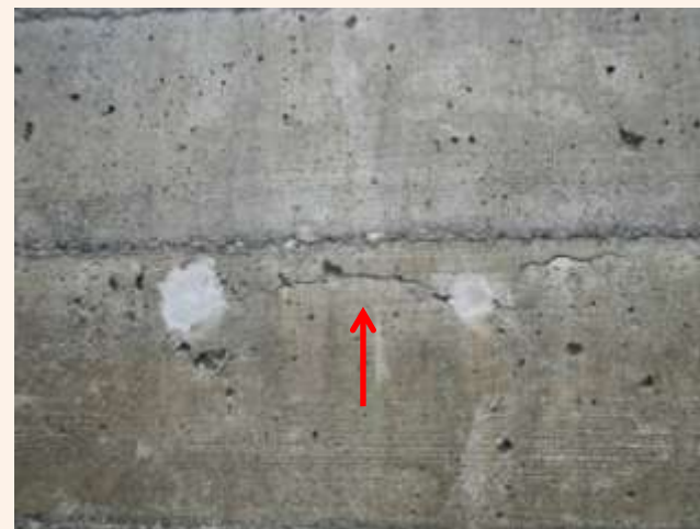
セパレータのコーン跡下方の沈下ひび割れ
