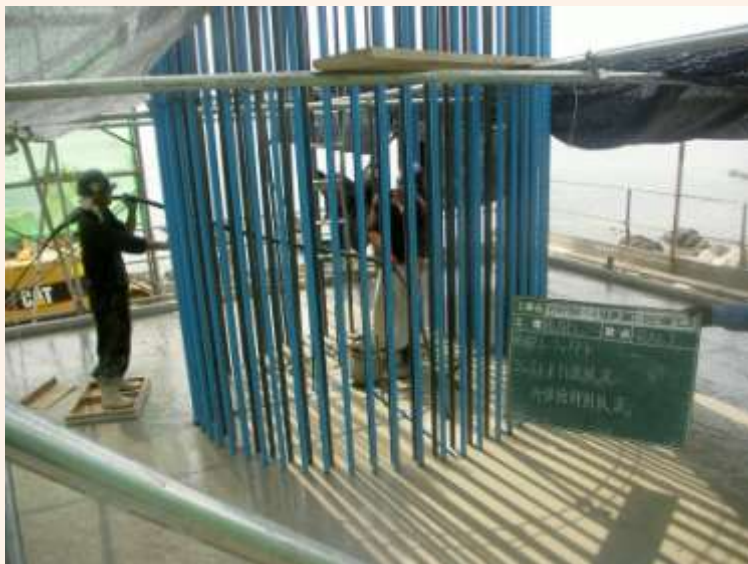
部材内部に入ること、柱とフーチングの接合部は、過密配筋であるため綿密な締固めが必要。
