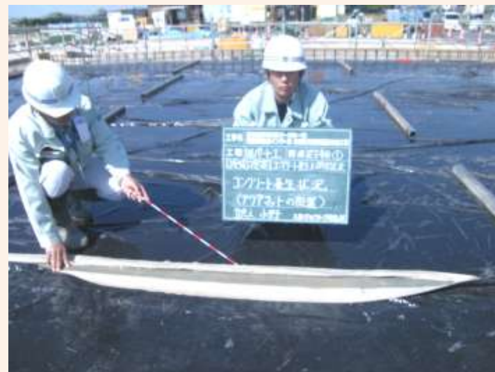
夏季におけるコンクリート表面積が大きい床版等での養生(保水効果に優れた養生マットの使用)
