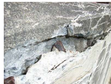
写真 2.3.4 L側桁部内側の状況 (破断鉄筋の露出)
