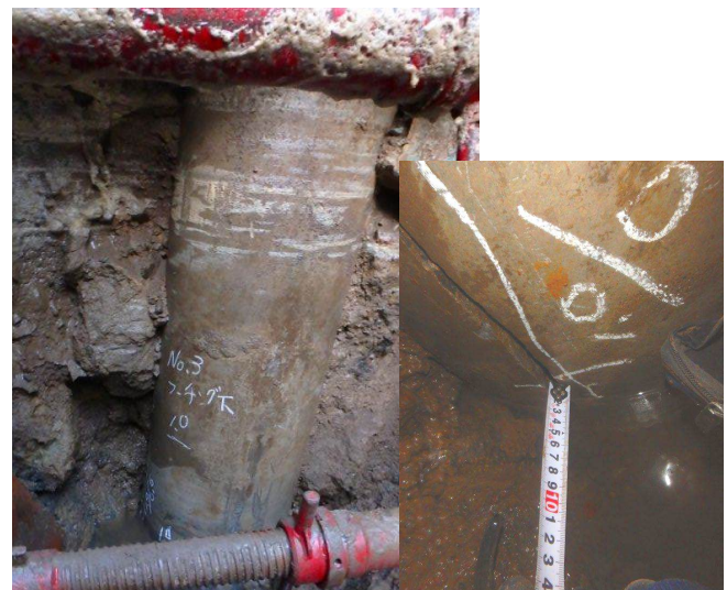
写真-2 杭頭付近の損傷状態・拡大写真
