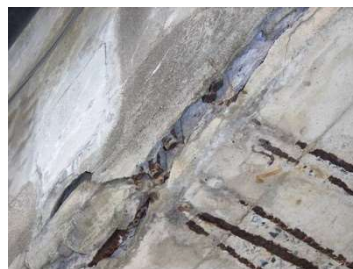
写真 2.3.5 L側桁部外側の状況 (P1近傍、破断鉄筋の露出)
