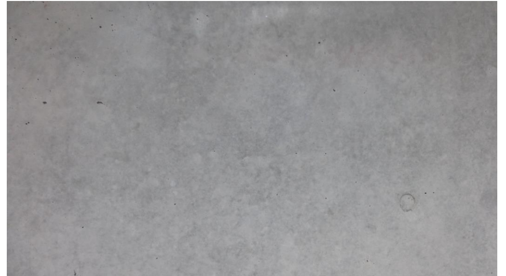
コンクリート表面（拡大）
