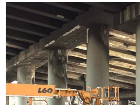
崩落後の状況
