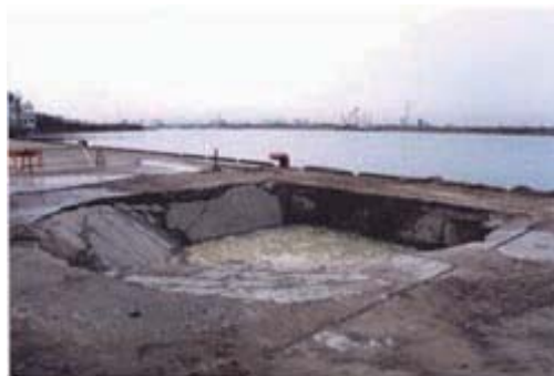
陥没した港湾施設のエプロン部
