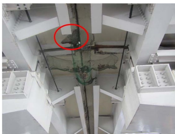
コンクリート剥落状況
