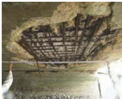
内部の鉄筋が露出した橋梁分
