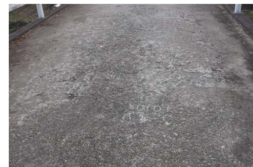
橋面舗装補修:補修前
