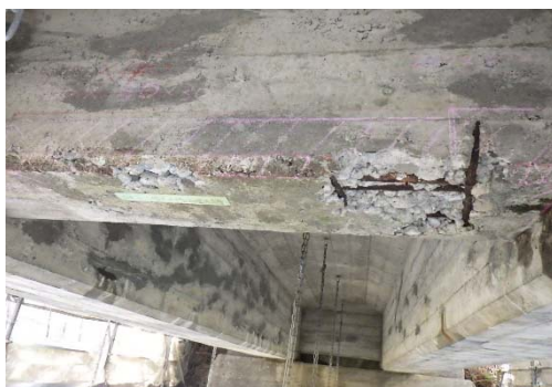
補修前(鉄筋露出)
