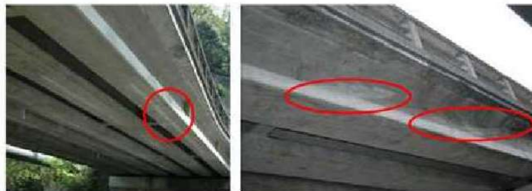
下フランジのひび割れ
