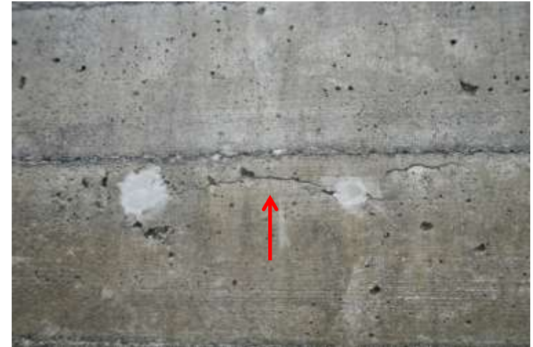
セパレータのコーン跡下方の沈下ひび割れ
