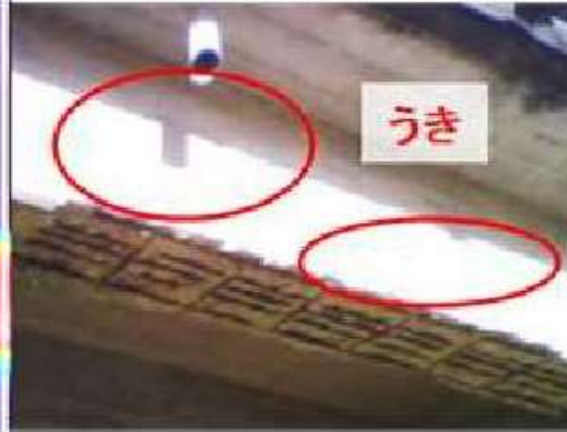
鉄筋が露出している
