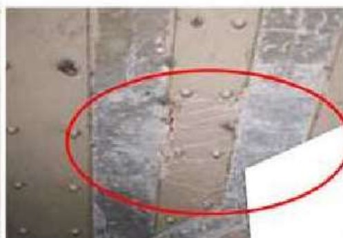
鋼板の周辺のうき
