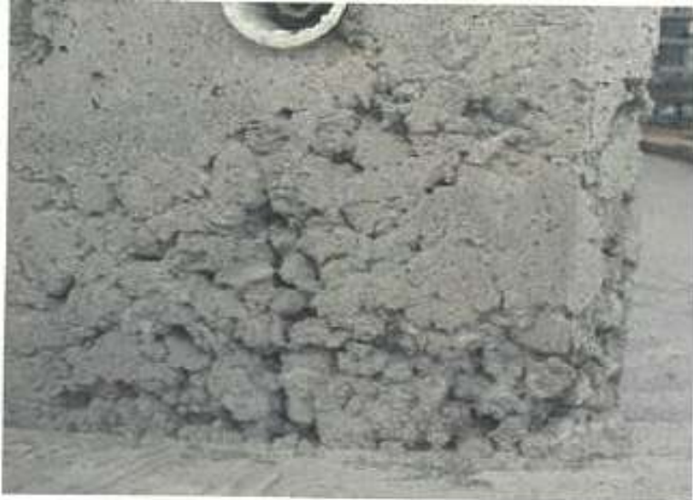
解説 図 7.3.11 柱部下端の 豆板 の発生状況
