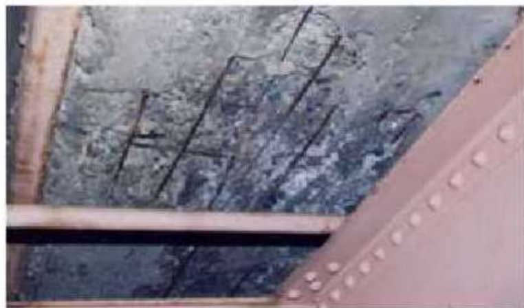
鉄筋が露出している
