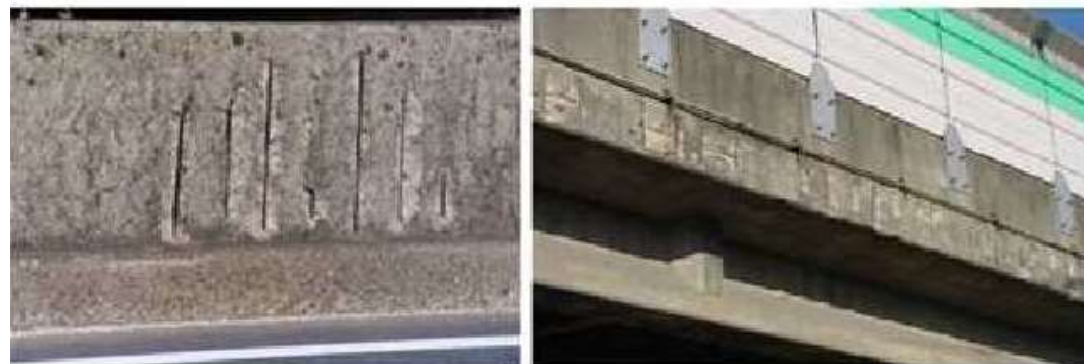
鉄筋が露出している
