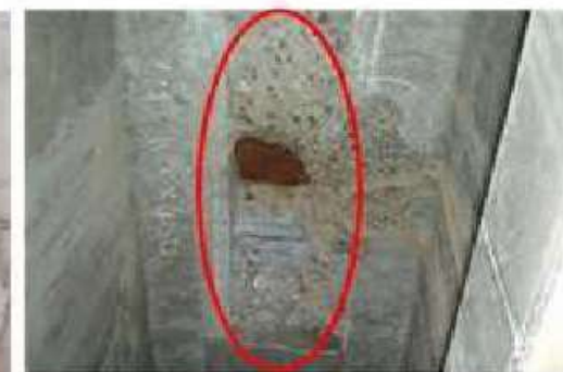
間詰め部の抜け落ち
