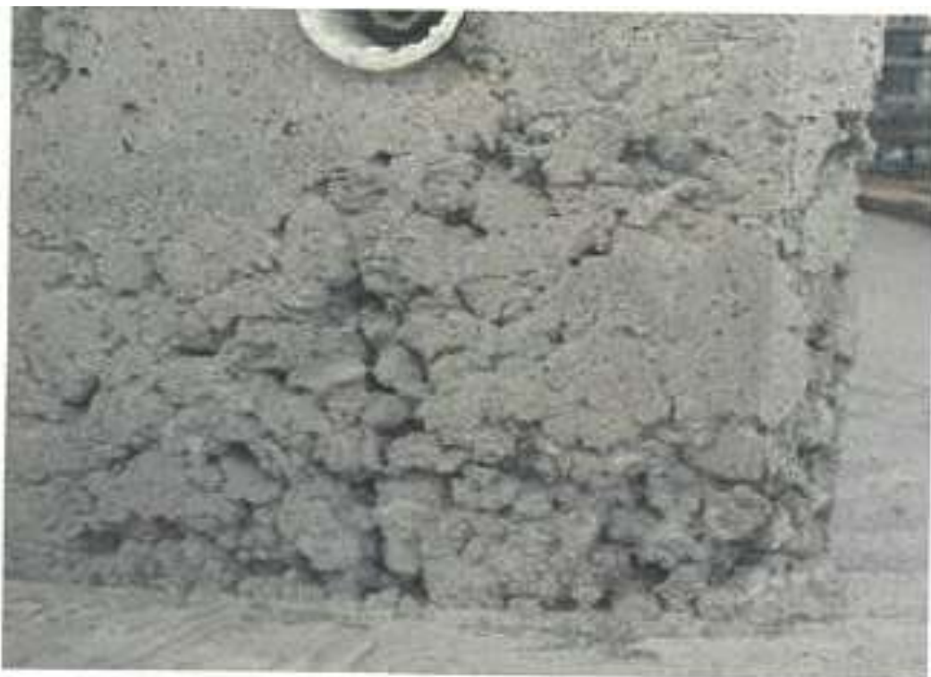
解説 図 7.3.11 柱部下端の豆板の発生状況
