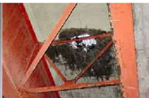
コンクリートの抜け落ち
