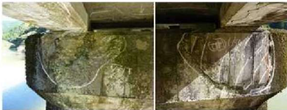
橋脚桁受け前面のうき
