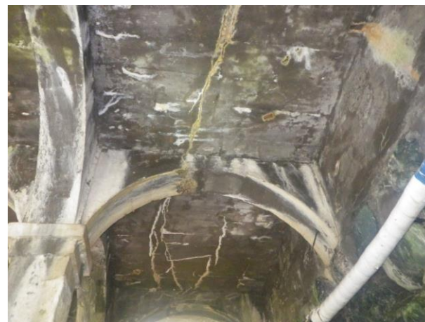
【上部構造（床版）】 ・漏水、遊離石灰 ・判定区分Ⅲ
