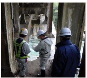
◀現地見学 (大宮橋の損傷状況を確認) 愛媛大学 森伸一郎准教授と連携し、 高度な専門知識や点検手法を学ぶ取組み。)
