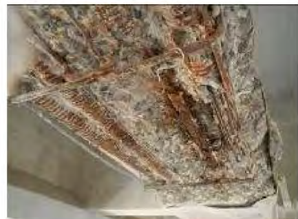
塩害による PC ケーブルの損傷状況
