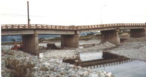
写真-5.4.20 下部構造の異常による上部構造の異常たわみ
