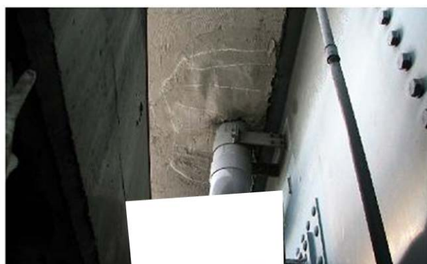
写真-5.2.42 補修・補強材 (繊維) の損傷の診断における留意点
