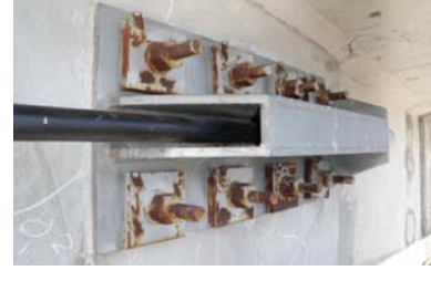
外ケーブル定着部 （定着部が腐食している）
