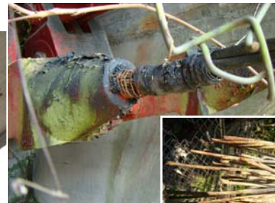
吊橋ケーブル定着部 （内部ケーブルが破断している）
