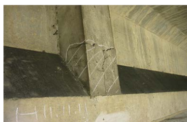
横締め の定着部 (定着部のコンクリートにひびわれ、うきが生じている)
