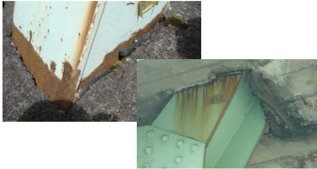
写真-5.1.21 鋼橋の腐食の診断における留意点
