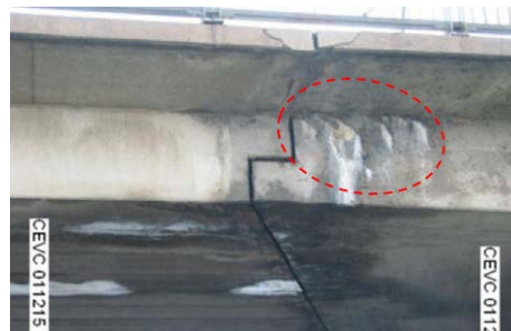
写真-5.2.7 ゲルバー部のひび割れ
