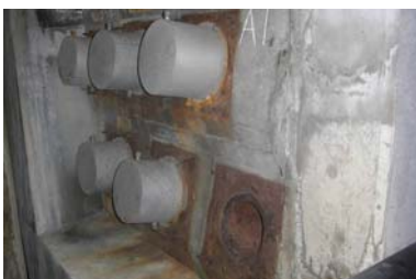
外ケーブル定着部 （定着部の鋼材に著しい腐食が見られる）
