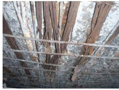
剥離・鉄筋露出、PC鋼材破断
