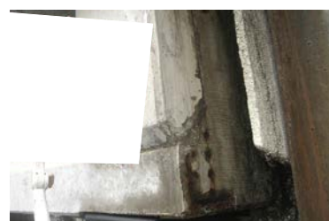
プレテンション桁の定着部 （定着部に腐食とコンクリートの剥離が生じている）
