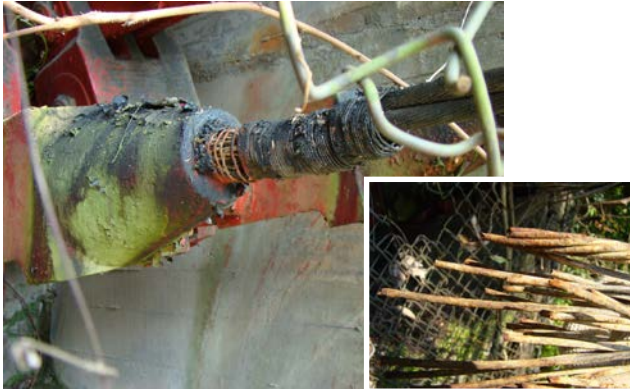
写真-5. 1. 33 吊橋ケーブル定着部の破断の例
