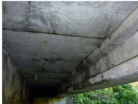
プレキャスト床版継目部からの漏水
