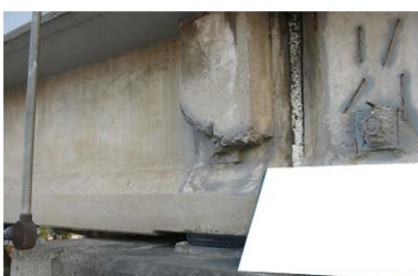
横締め の定着部 (定着部のコンクリートが剥離し、定着部の鋼材が露出)
