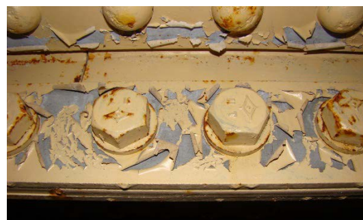
写真-5.1.3 塗装にはがれが生じた例 (塗装が施工不良である場合、層間剥離が生じることがある。)
