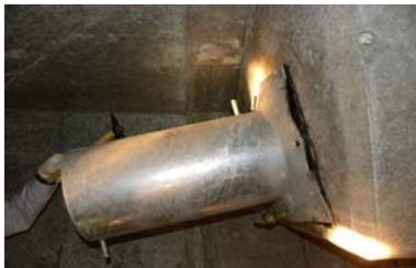
エクストラドローズド橋定着部 （斜材のケーブルが破断したことにより桁内の定着部カバーが変形して外れている）
