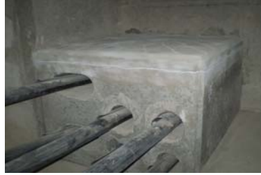
外ケーブル定着部 （定着突起にひびわれ、うきが 生じている）
