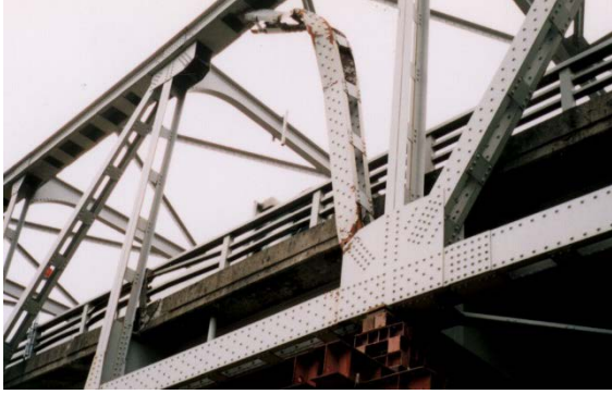
写真-5. 1. 31 車両の衝突による破断の例
