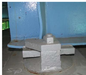
(d) 支点上の局部座屈(クリッピング)
