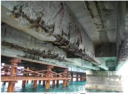
剥離・鉄筋露出
