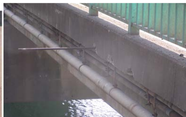
横締め の定着部 (横締め PC 鋼材が抜け出している)
