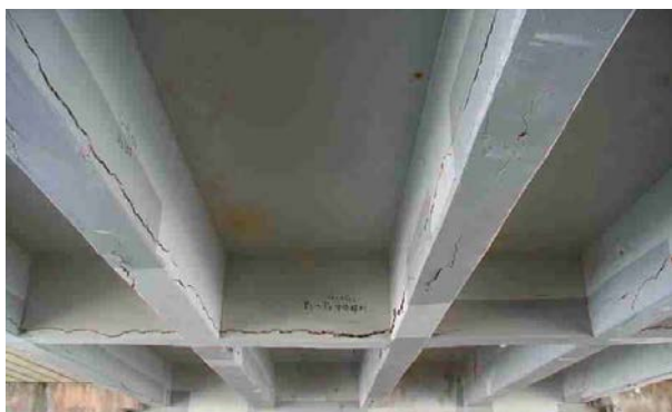
写真-5.2.16 ひび割れの診断における留意点
