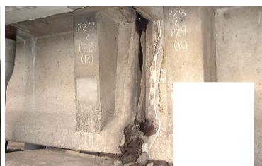
主桁端部の定着部 (主桁端部に著しいひびわれと剥離が見られる)
