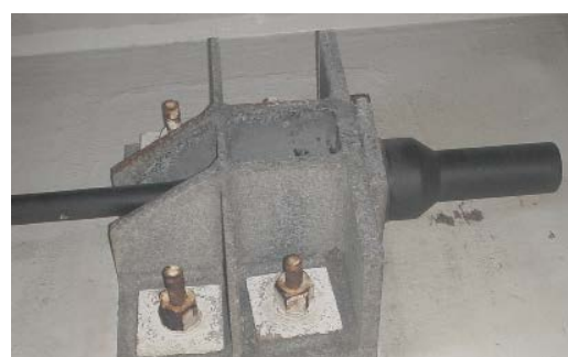
写真-5.1.8 一部にさびが現れた例
