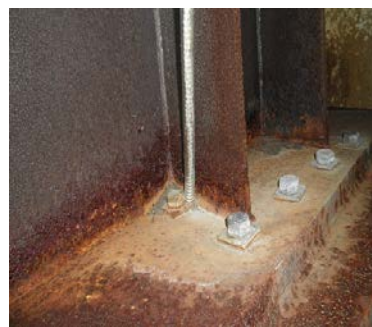
写真-5.1.13 耐候性鋼材の異常腐食の例
