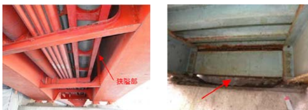
添架物がある場合 狭隘な場合（端横桁背面） →必要に応じてビデオカメラ等の機器も併用する。 同一部材の周囲の損傷状況等も参考にして診断する。
