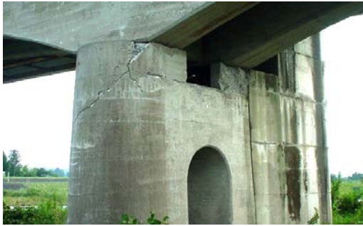
(a) 橋座部から柱部へ伸びる斜めひび割れの例
