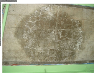
写真-5.3.7 舗装の異常の診断における留意点
