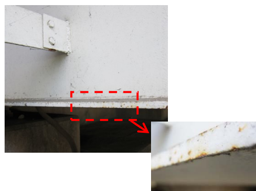
写真-5.1.6 鋼部材エッジ部の膜厚不足
