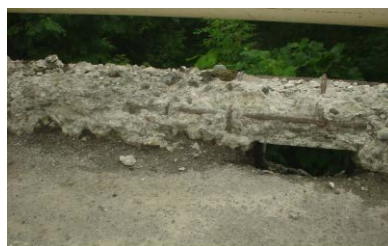
写真-5.2.5 凍害による スケーリング（地覆部）
