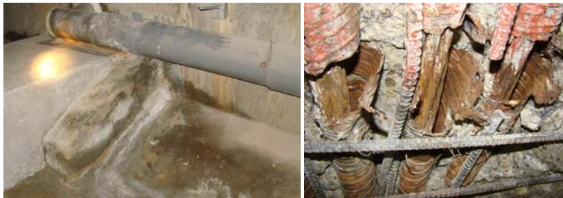
写真-5.2.14 排水管からの漏水とPC鋼材の腐食
