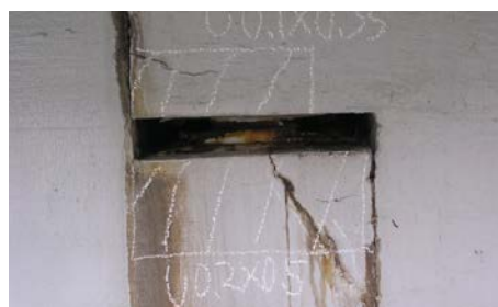
写真-5.2.8 ゲルバー部のひび割れ
