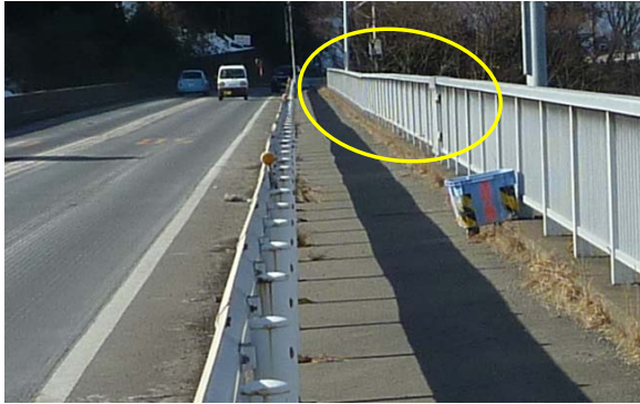
写真-5.4.18 PC ラーメンヒンジ部の異常たわみ
