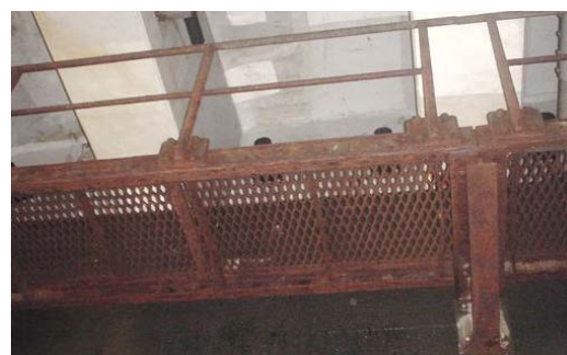
写真-5.1.9 めっき層が消耗して 鋼材の板厚減少が生じた例
