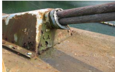
斜張橋ケーブル定着部（桁側） （腐食により隙間が生じている）
