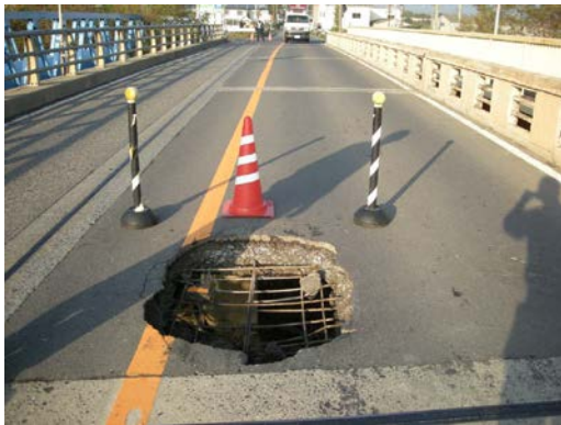
写真-5.2.36 抜け落ちの診断
