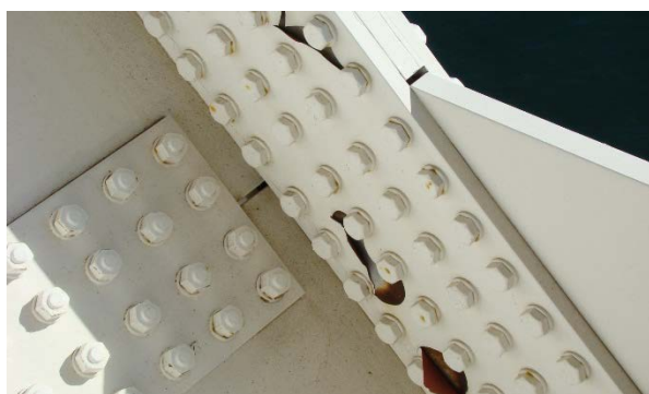
写真-5.1.5 連結部の塗膜のわれ、うき
