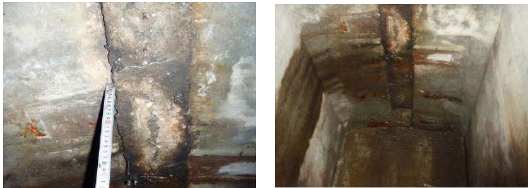
図-3.2.6 PCT 桁の間詰め部の写真（漏水、さび汁）
