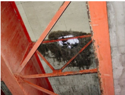
コンクリート床版の抜け落ち
