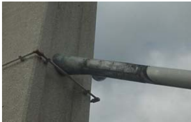
斜張橋ケーブル定着部（主塔側） （保護管に漏水が生じている）
