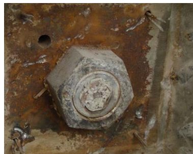
横桁定着部 (コンクリート内部で腐食。写真はコンクリートをはった例)
