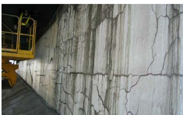
写真-5.2.18 ひび割れの診断における留意点
