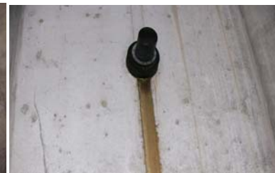
落橋防止システム定着部 （定着部にさび汁が見られる）
