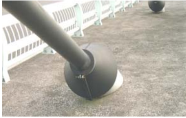
斜張橋ケーブル定着部（桁側） （保護カバーがあるため定着部の口元を点検できない）
