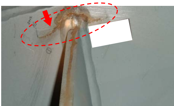
写真-5.1.38 鋼橋の亀裂の診断における留意点
