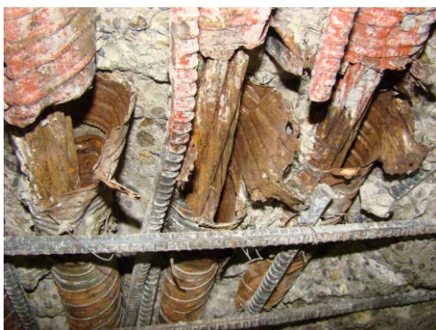
写真-5.4.2 部材内部のケーブル腐食の例
