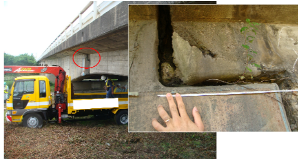
写真-5.4.21 ゲルバー支点部の異常な振動（写真はベント設置による応急処置）
