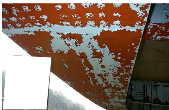
写真-5.1.2 塗装にはがれが生じた例 (塗膜が広く剥離し、下塗りが露出している。)
