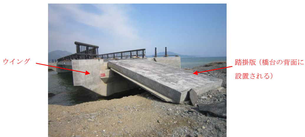
図-2.2.71 橋台背面の踏掛版（被災状況の写真）
