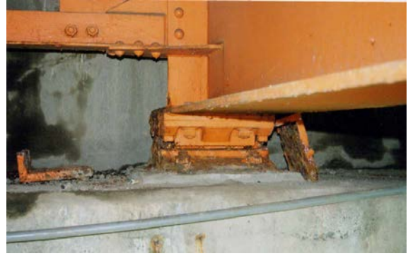
写真-5. 1. 32 地震による支承サイド ブロックの破断の例
