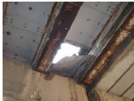
写真-5.2.37 抜け落ちの診断における留意点
