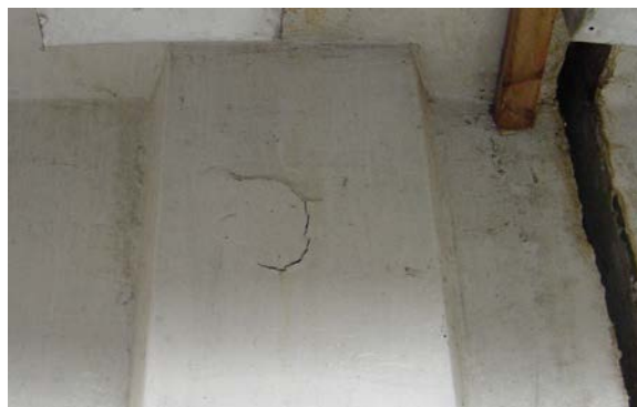
写真-5.4.8 定着部の異常の診断における留意点
