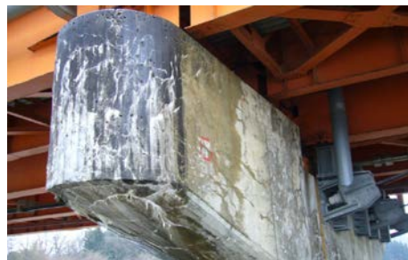
写真-5.2.2 アルカリ骨材反応による亀甲状のひびわれ
