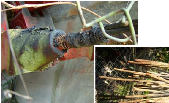
写真-5.4.5 定着部の異常の診断における留意点
