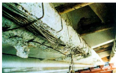
写真-5.2.1 塩害による損傷
