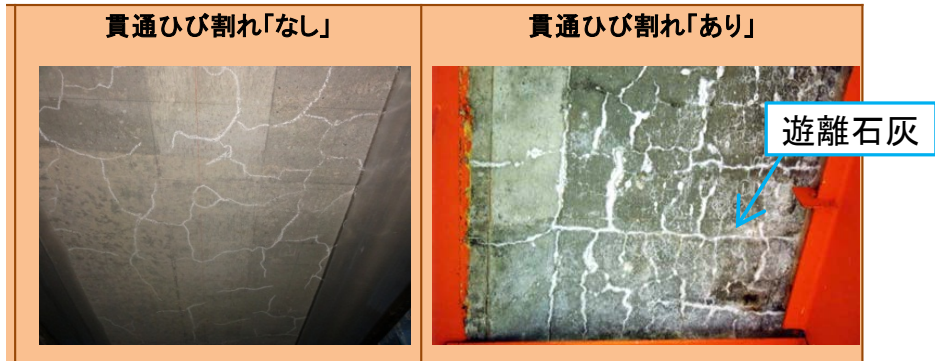
状態 iv 2方向ひび割れ 漏水・遊離石灰 なし
