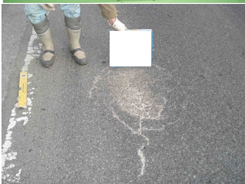
写真-5.5.13 鉄筋コンクリート床版の疲労によるひびわれの診断における留意点
