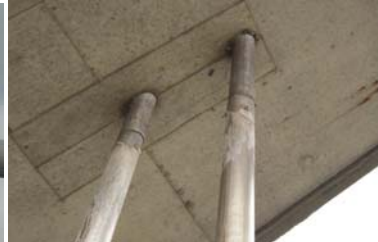
アーチ橋吊材定着部 （上側定着部から漏水が生じている）
