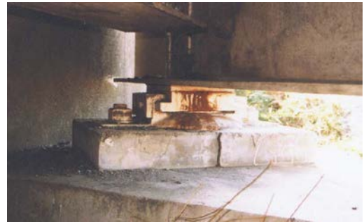
(b) 台座モルタルの損傷の例
