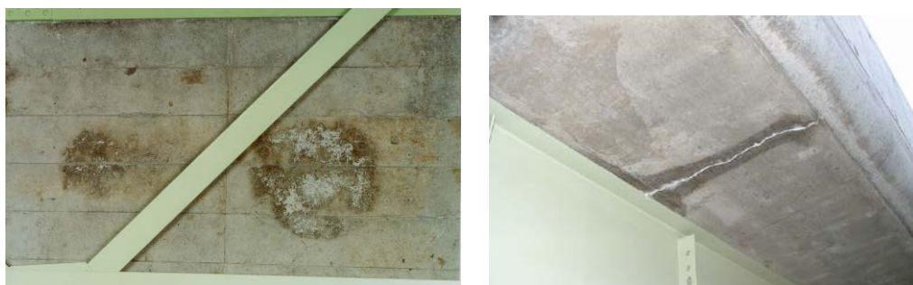
写真-5.2.31 貫通ひびわれが疑われる事例
