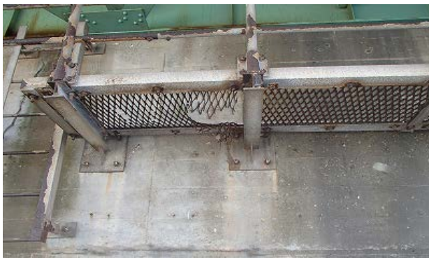
写真-5.1.22 鋼橋の腐食の診断における留意点
