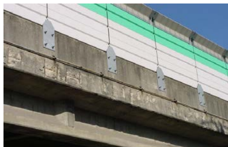
写真-5.2.3 中性化による地覆部外側の剥離・鉄筋露出
