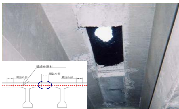
写真-5. 2. 35 抜け落ちの診断における留意点
