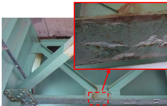
写真-5.1.24 鋼部材の腐食の診断における留意点
