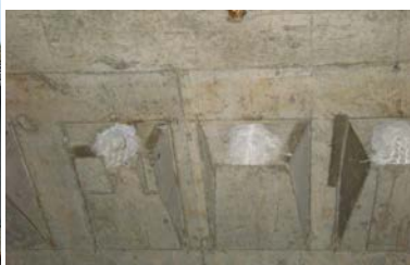
箱桁内部（上床版）定着部 （後打ちコンクリートの隙間から漏水と遊離石灰の析出）
