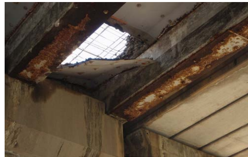
鋼板接着補強されたコンクリート床版の抜け落ち
