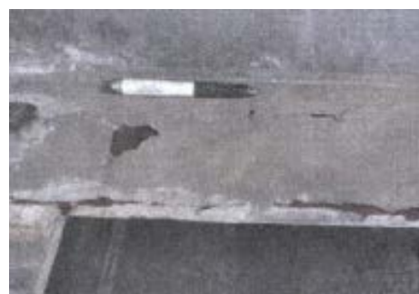
写真-5.1.11 金属溶射にさびが生じた例
