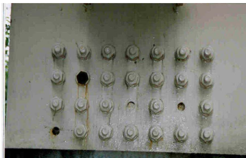
図-3.2.2 遅れ破壊が生じたボルトが脱落した接合部の例
