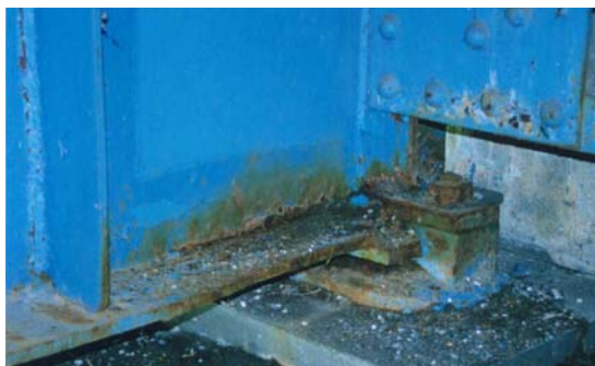
写真-5.1.26 鋼橋の腐食の診断における留意点
