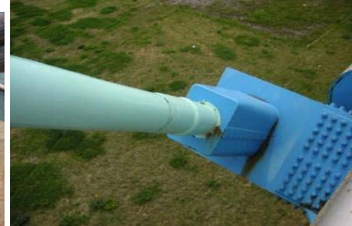
斜張橋ケーブル定着部（桁側） （定着部にさび汁が見られる）
