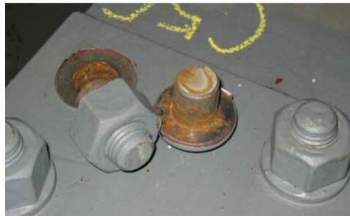
写真-5.1.52 破断したボルトの例
