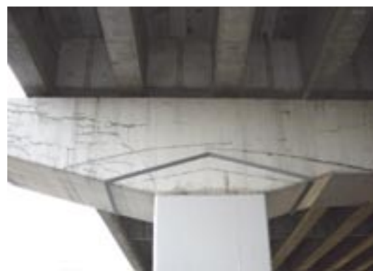
写真-5.12 コンクリート部材の塗装に変状が生じた例
