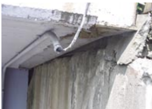
写真-13.5 床版とパラペットが接触し、 パラペットに損傷が生じた例
