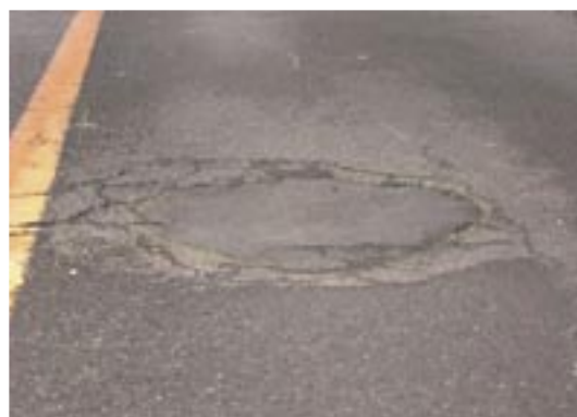
写真-14.6 舗装の陥没の例
