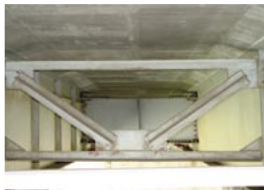
写真-19.6 鋼部材の塗装が変色した例
