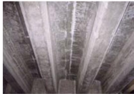
写真9.5 間詰部に漏水が生じた例
