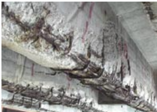
写真-7.9 露出した鉄筋が腐食、破断している例
