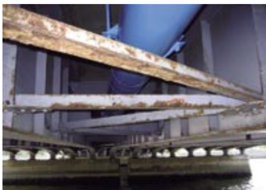
写真-5.7 鋼材の腐食の例
