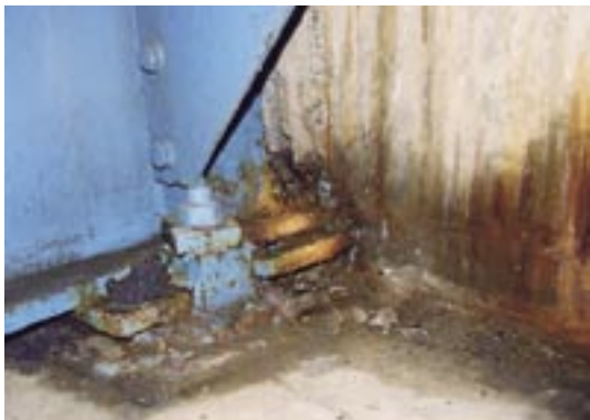
写真-13.7 桁と橋台の接触に伴い、支承の変形が生じた例
