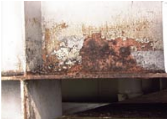
写真-1.1 集中的に錆が発生した例
