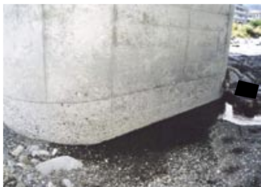
写真-26.1 基礎周辺の土が流水により消失した例
