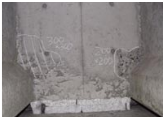
写真-12.7 端横筋こうきと剥離が生じた例 (注: うきはチョークのマーキング部分である)
