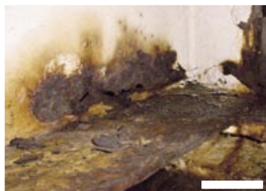
写真-1.15 腐食と同時亀裂 (断面欠損) を生じた例
