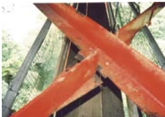
写真4.1 横構に生じた例
