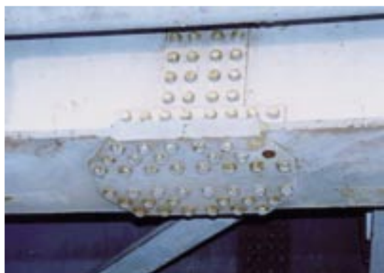
写真-3.1 ボルトが脱落した例
