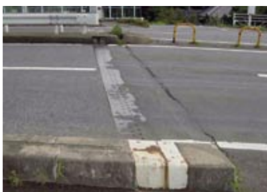
写真-14.8 橋台パラペット背面の段差の例
