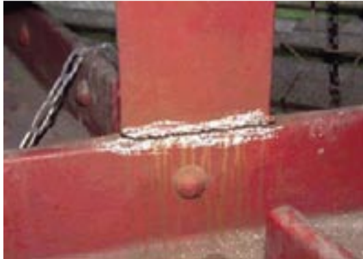
写真-21.5 横溝と吊り材との溶接合部の破断により、異常な音を発生した例
