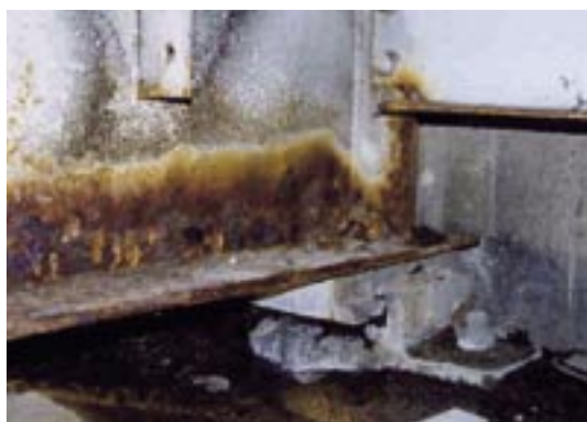
写真-1.5 断面欠損を伴う錆が発生した例
