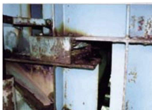
写真-16.4 変位追随機能が損なわれている状態の例
