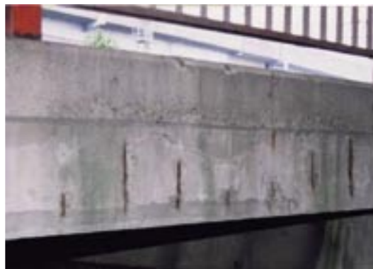
写真-7.2 剥離・鉄筋露出が生じた例
