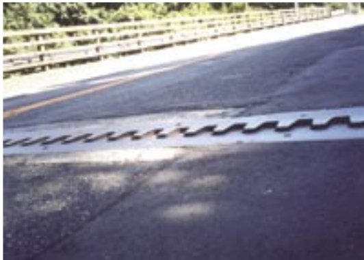
写真-14.3 伸縮継手部の異常な段差の例
