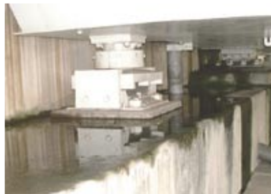
写真-20.5 橋壑に滞水した例
