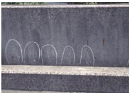
写真-12.1 コンクリートのうきが生じた例 (注: うきはチョークのマーキング部分である)
