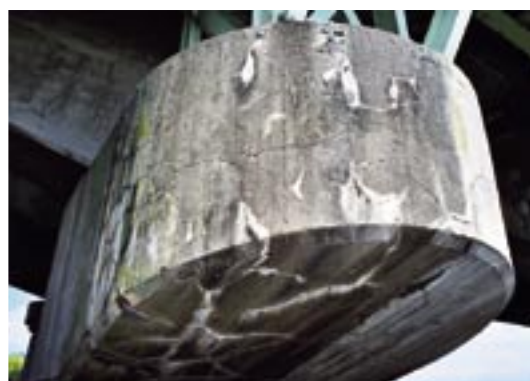
写真-8.6 T型橋脚のひびわれ部から生じた例
