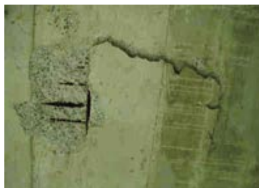
写真-12.10 床版下面こうきと剥離・鉄筋露出が生じた例
