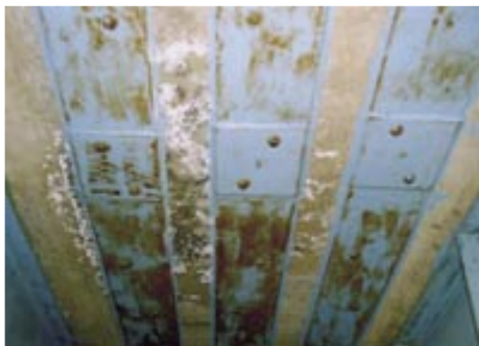
写真-10.5 床版の補強鋼板部々に遊離石灰が滲出した例
