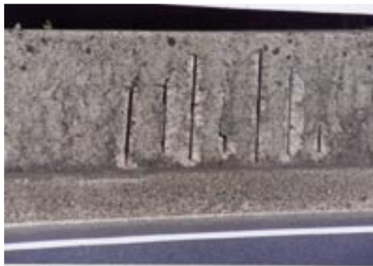
写真-7.1 剥離・鉄筋露出が生じた例
