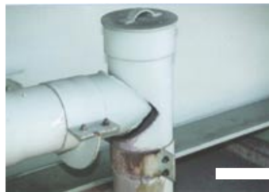
写真-20.9 排水管の破損の例
