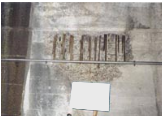
写真-7.5 剥離・鉄筋露出が生じた例
