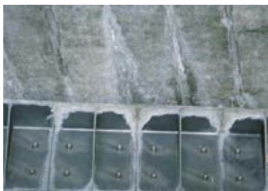
写真-5.3 メッキに変色が生じた例
