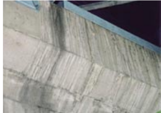
写真8.8 表面を伝う水によって析出物が発生した例
