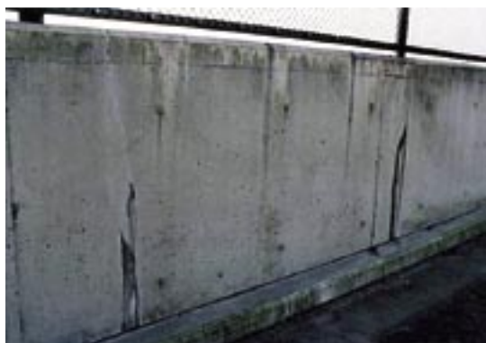
写真-6.3 高欄のひびわれが生じた例
