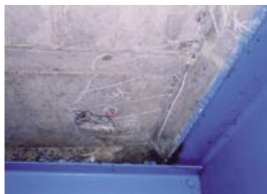
写真-12.8 床版こうきと剥離が生じた例 (注: うきはチョークのマーキング部分である)
