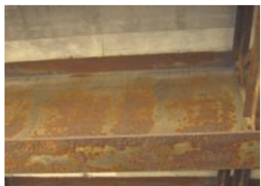
写真-5.5 耐候性鋼材に安定錆が形成されていない状態の例
