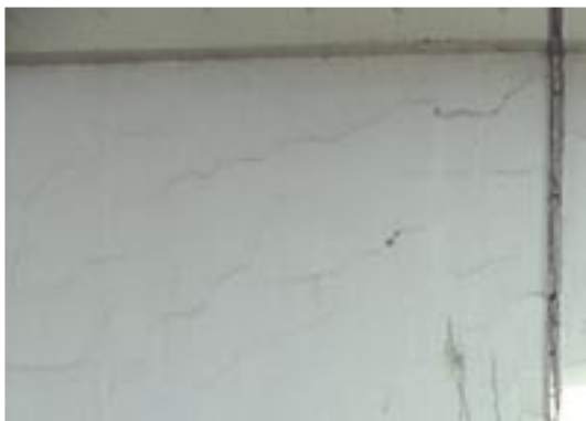
写真-10.7 塗装した橋台にひびわれが生じた例
