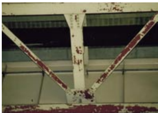
写真-5.1 塗装の剥がれが生じた例
