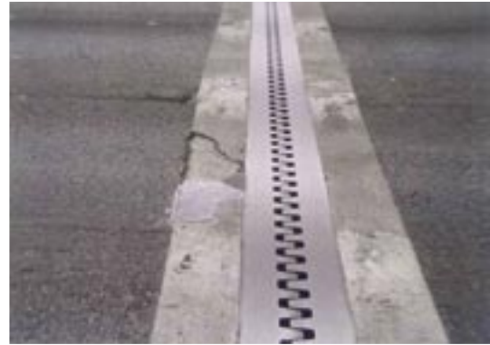
写真-14.2 伸縮装置の後打ち材損傷による段差の例
