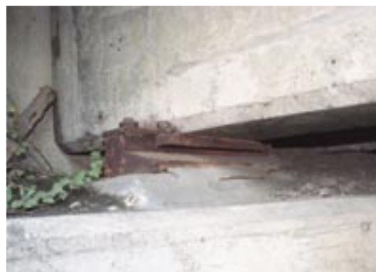
写真-5.8 鋼材の腐食の例
