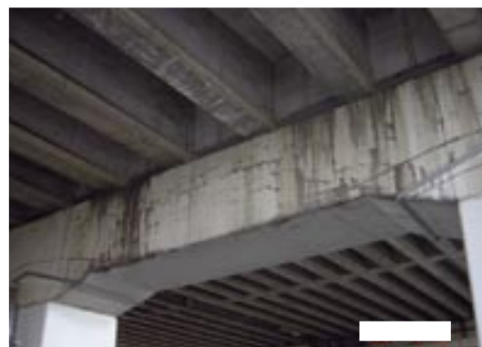
写真-6.4 ラーメン橋脚の梁部のひびわれが生じた例
