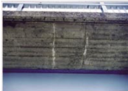
写真8.9 ひびわれ部から生じた例
