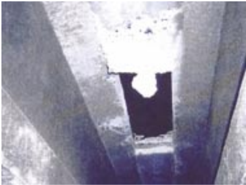
1) 間詰めコンクリートの抜け落ち
