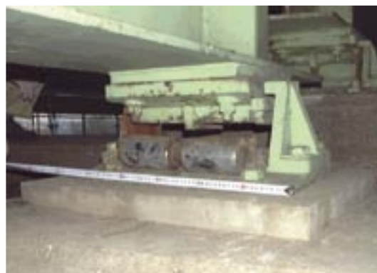
写真-16.6 支承ローラーの脱落の例
