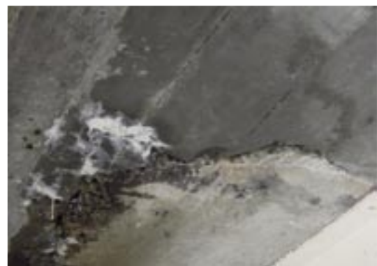
写真-9.9 床版に遊離石灰と漏水を伴うひびわれが生じた例
