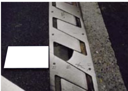
写真4.3 伸縮装置に生じた例
