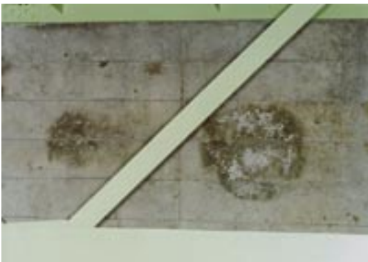
写真8.11 床版に生じた例
