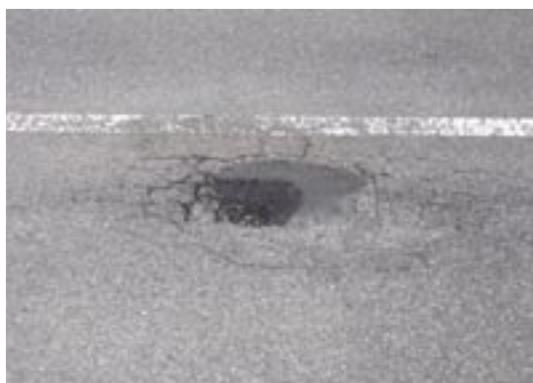
写真-14.5 舗装のポットホールの例
