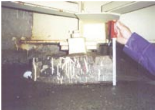
写真-25.1 支承に傾斜が生じた例
