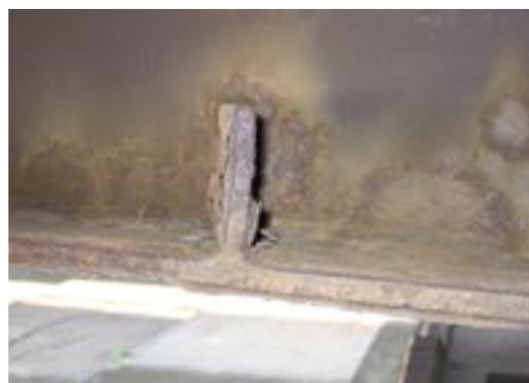
写真-5.10 耐候性鋼材に断面欠損が生じた例
