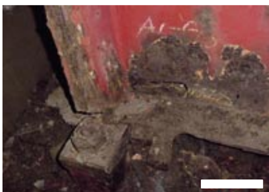
写真-1.14 腐食と同時亀裂 (断面欠損) を生じた例
