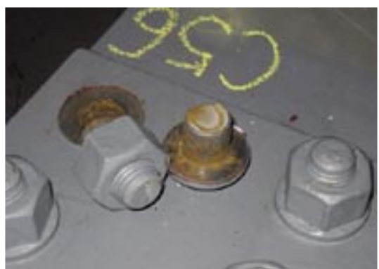
写真-3.3 ボルトが折損した例
