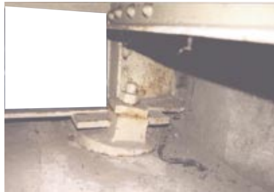
写真-25.2 支承に沈下・傾斜が生じた例
