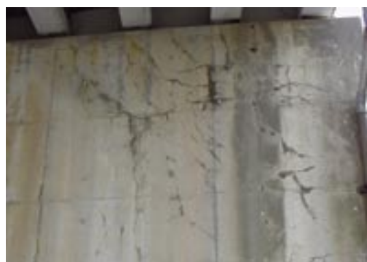
写真-6.5 橋台のひびわれが生じた例
