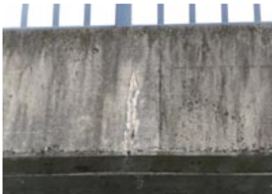
写真-8.1 車両用防護柵のひびわれ部から生じた例
