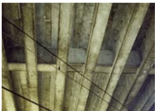
写真-17.5 すすによる表面の汚れの例
