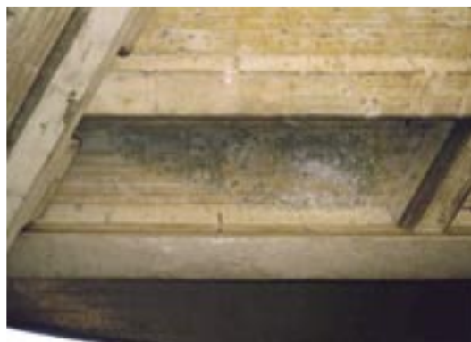
写真-19.2 コンクリート主桁の変色が生じた例
