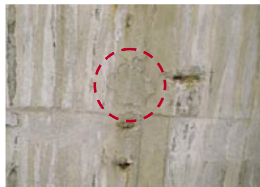
写真-12.6 コンクリートのうきが生じた例
