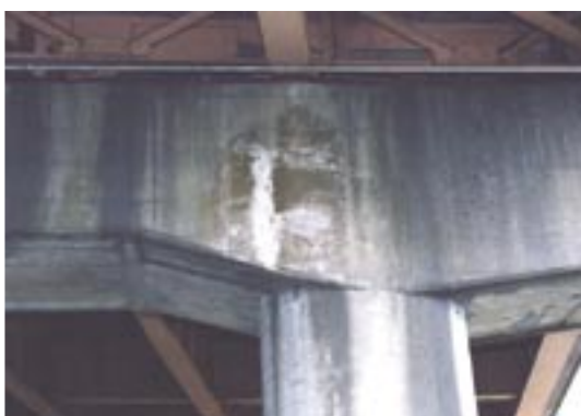
写真-8.5 ラーメン橋脚のひびわれ部から生じた例
