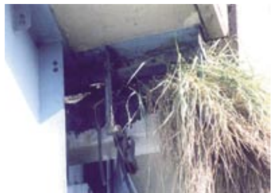
写真-24.6 排水樋に土砂詰りが生じた例
