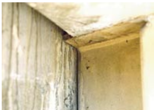
写真-13.1 主桁と橋台の接触が生じた例
