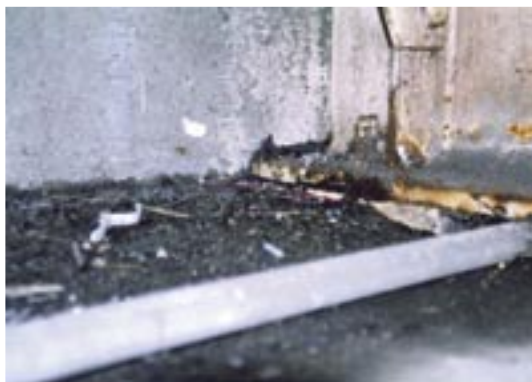
写真-24.3 支承周辺に土砂が堆積した例
