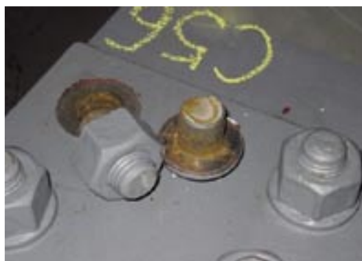
写真-4.8 ボルトが折損した例
