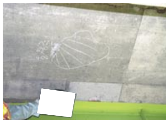
写真-12.2 コンクリートのうきが生じた例 (注: うきはチョークのマーキング部分である)
