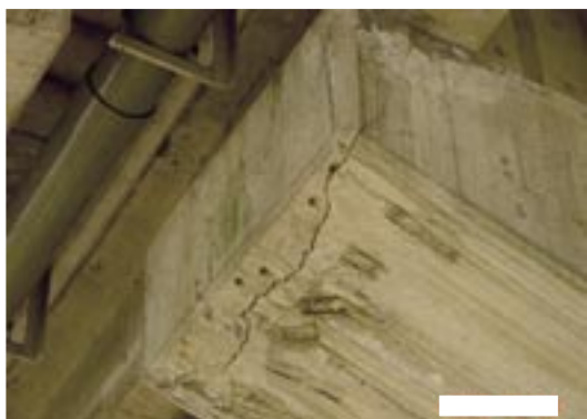
写真-6.7 ひびわれ以外にコンクリートの剥離と鉄筋の露出を生じた例
