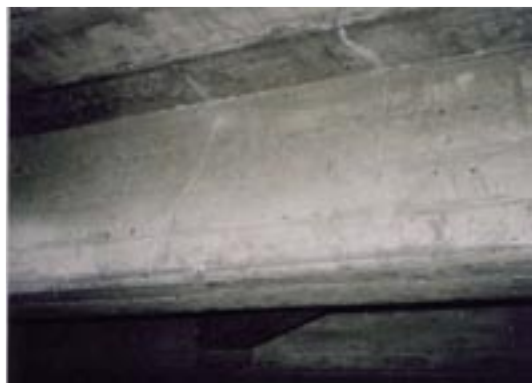
写真-6.1 主桁のひびわれが生じた例 (注: ひびわれをチョークでマーキングしてある)
