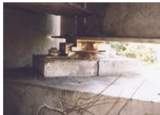
写真-16.12 台座コンクリートの損傷の例
