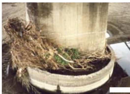
写真-26.4 基礎周辺の土が流水により著しく消失した例
