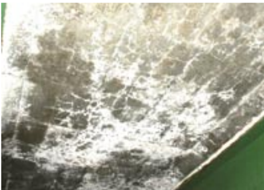
写真9.4 床版に遊離石灰の滲出を伴う亀甲状のひびわれが生じた例
