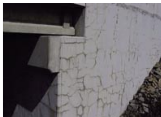
写真-6.6 橋台のひびわれが生じた例
