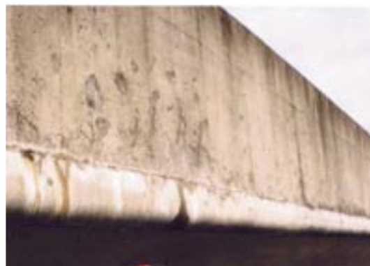
写真-8.2 張出し床版と地覆の打継目から生じた例
