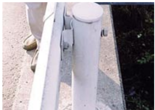
写真-3.5 ボルトにゆるみが生じた例
