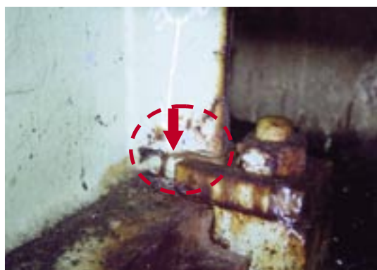
写真-2.6 亀裂が生じた例
