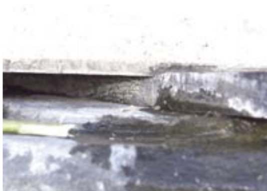
写真-19.3 ゴム支承のひびわれが生じた例
