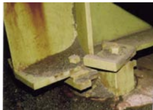
写真-23.6 支承のピンチプレートに変形が生じた例
