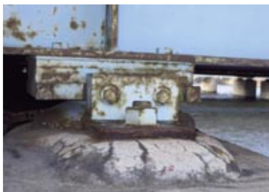
写真-16.9 沓座モルタルの損傷の例
