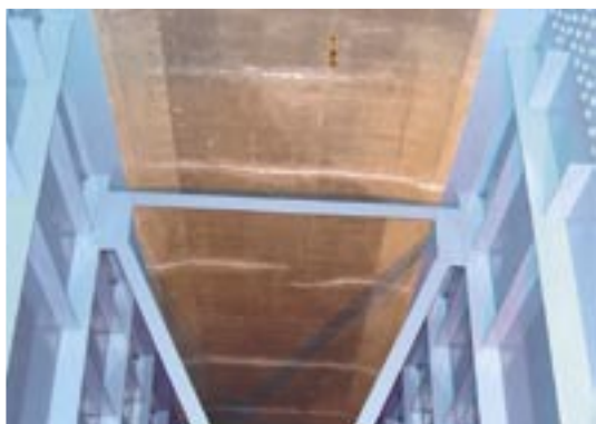
写真-11.1 床版下面に一方向のひびわれを生じた例
