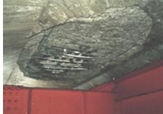
写真9.2 コンクリート塊が抜け落ちた例
