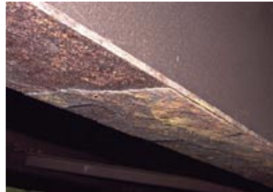
写真-1.2 耐候性鋼材に断面減少を伴う異常な錆が発生した例
