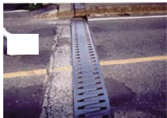
写真-25.7 伸縮装置の後打ち材にひび割れが生じた例
