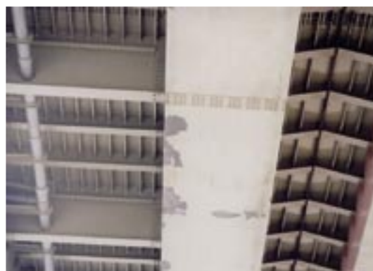
写真-5.2 塗装の剥がれが生じた例
