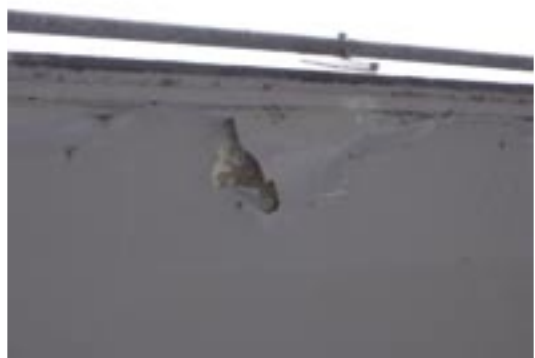
写真-5.11 コンクリート部材の塗装が剥がれが生じた例
