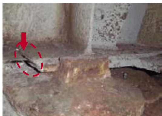
写真-2.8 腐食による断面減少と同時に亀裂が生じた例
