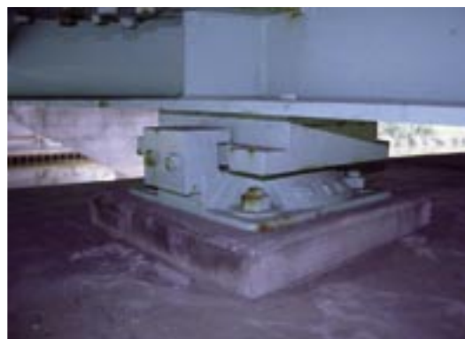
写真-1.6 断面欠損を伴わないと見なせる程度の軽微な錆が発生した例
