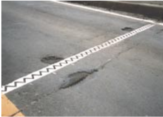
写真-14.1 舗装の損傷による段差の例
