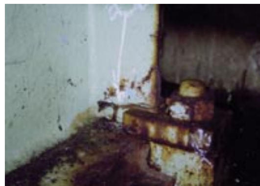
写真-1.12 腐食と同時亀裂を生じた例
