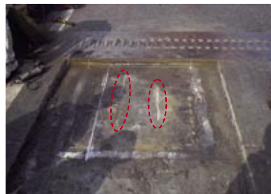
2) 舗装撤去後、鋼材版の亀裂
