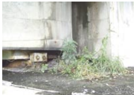
写真-24.4 支承周辺に土砂が堆積した例
