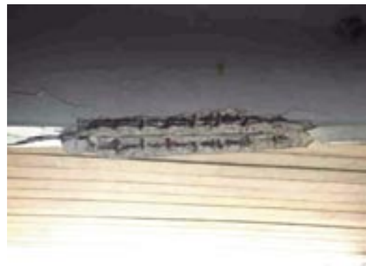
写真-10.8 塗装した主桁に剥離、鉄筋露出が生じた例
