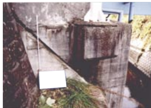
写真-25.4 橋台が移動した例
