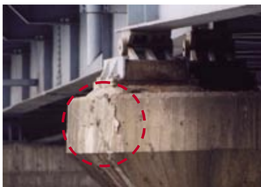
写真-12.5 コンクリートのうきが生じた例
