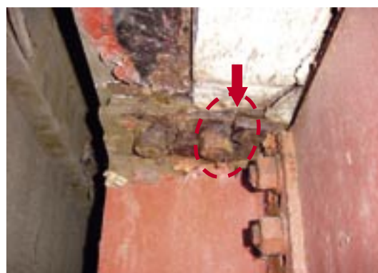
写真-2.7 亀裂が生じた例
