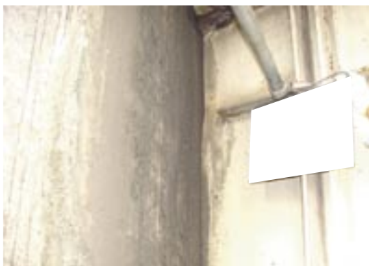
写真-25.6 主桁とパラペットの接触が生じた例
