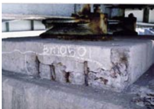
写真-16.11 台座コンクリートの損傷の例
