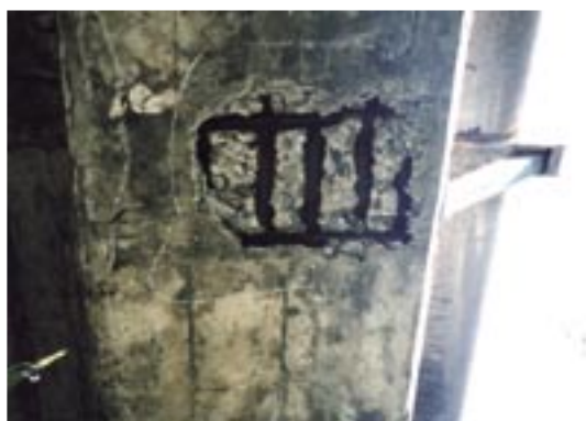
写真-12.9 主筋と剥離・鉄筋露出が生じた例 (注: うきはチョークのマーキング部分である)
