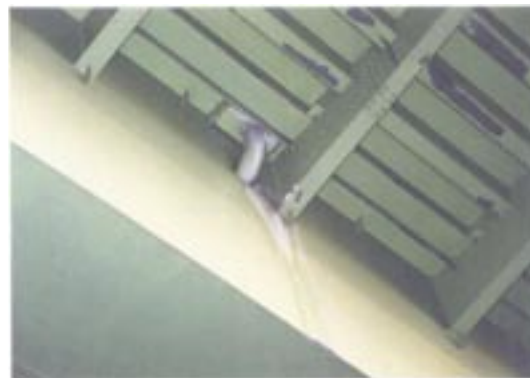
写真-20.2 排水柵から漏水が生じた例
