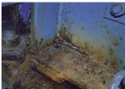
写真-1.11 腐食と同時亀裂を生じた例 (注: 亀裂をチョークでマーキングしている)
