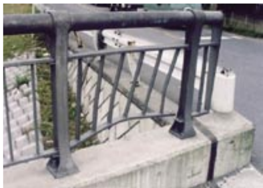
写真-23.9 車両用防護柵に変形と破断が生じた例
