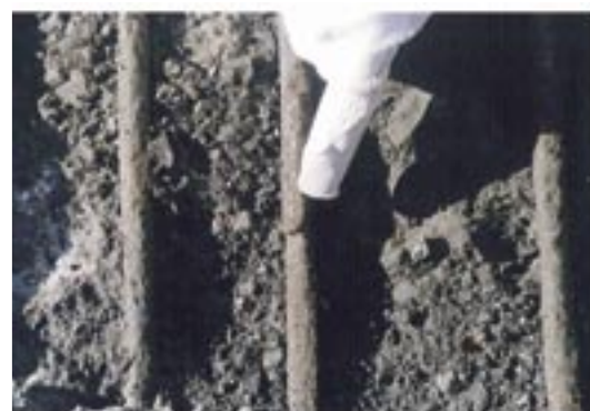
写真-15.4 床版上面のコンクリートの土砂化と同時に鉄筋の腐食、破断が生じた例 (注:舗装撤去している)
