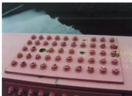
写真-3.2 ボルトが脱落した例
