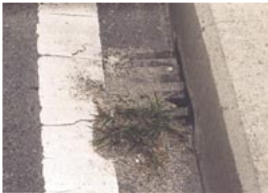
写真-24.1 排水柵に土砂詰りが生じた例
