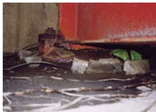
写真-16.10 沓座モルタルの損傷の例
