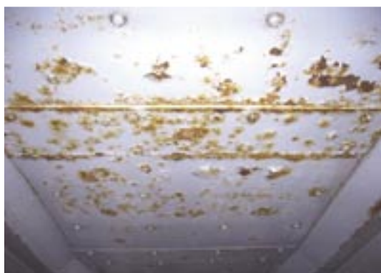
写真-10.1 床版の補強鋼板に腐食が生じた例
