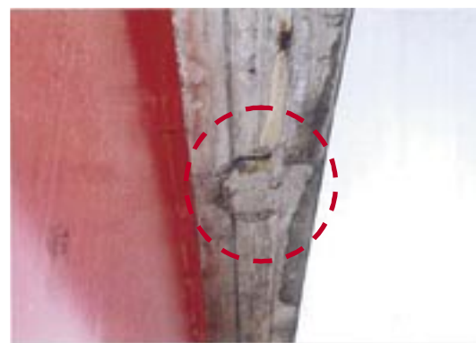
写真-12.4 コンクリートのうきが生じた例
