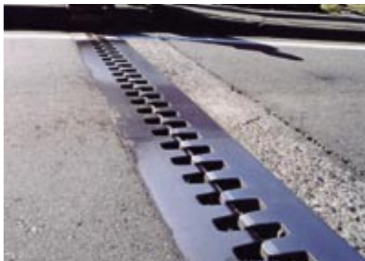
写真-25.8 伸縮装置に段差と遊間の異常な開きが生じた例
