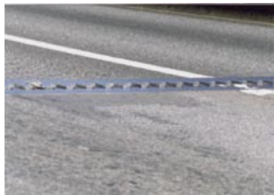
写真-13.8 伸縮装置部に段差が生じた例
