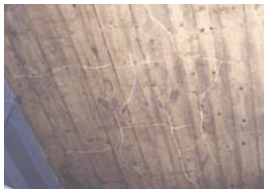
写真-11.4 床版下面に二方向のひびわれを生じた例 (注:ひびわれはチョークでマーキングしてある)
