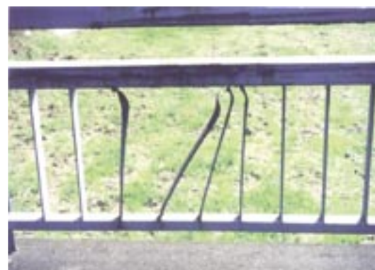
写真4.4 防護柵に生じた例
