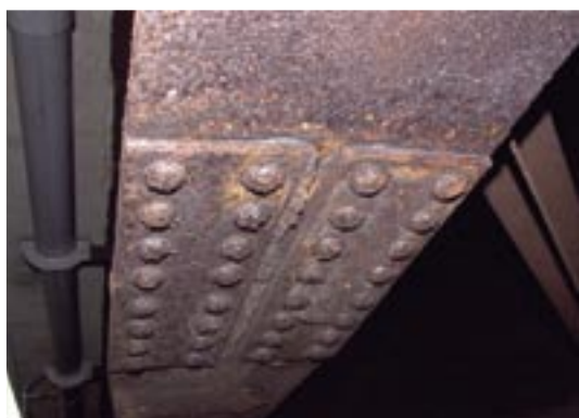
写真-1.7 耐候性鋼材の錆の状態が一樣でなく、断面欠損を伴う例
