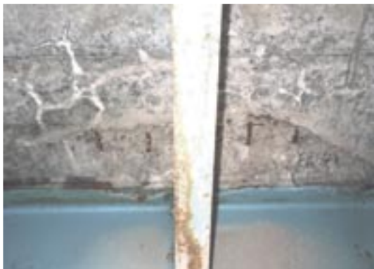
写真-11.7 床版下面のひびわれとコンクリートの剥離、鉄筋露出が生じた例
