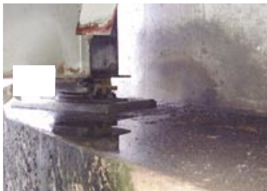
写真-20.4 橋壑に滞水した例
