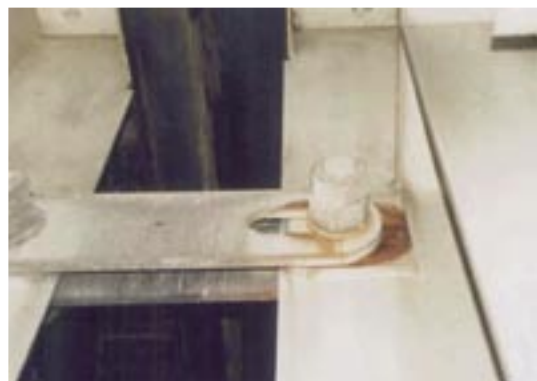
写真-13.10 耐震連結装置の移動状態に偏りが生じた例
