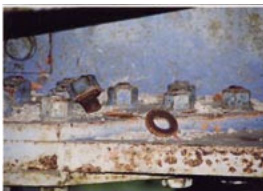
写真-3.4 ボルトが折損した例
