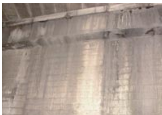
写真-19.7 コンクリート表面を伝う水によって発生した汚れの例
