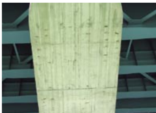
写真-7.4 剥離・鉄筋露出が生じた例
