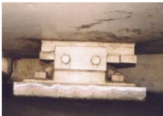
写真-13.9 支承の移動状態に偏りが生じた例
