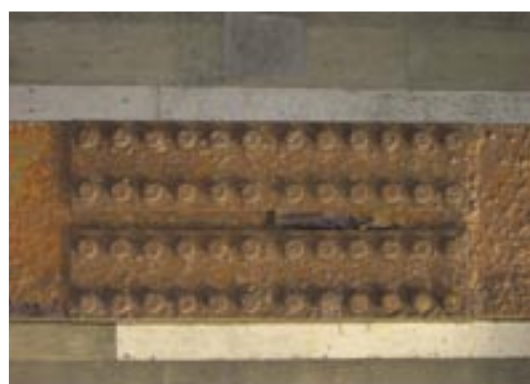
写真-5.6 耐候性鋼材に安定錆が形成されていない状態の例
