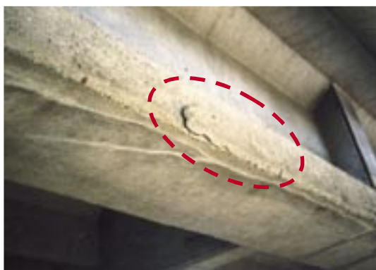
写真-12.3 コンクリートのうきが生じた例
