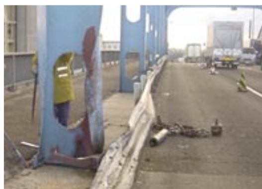
写真-4.6 吊り材の破断しているとみなせる程度の割裂と変形が生じた例
