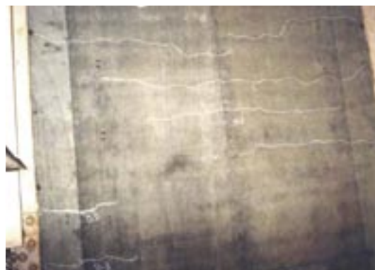
写真-11.2 床版下面に一方向のひびわれを生じた例 (注:ひびわれはチョークでマーキングしてある)
