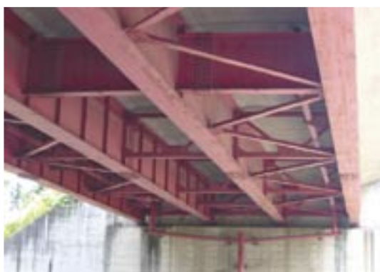
写真-19.5 鋼部材の塗装が変色した例
