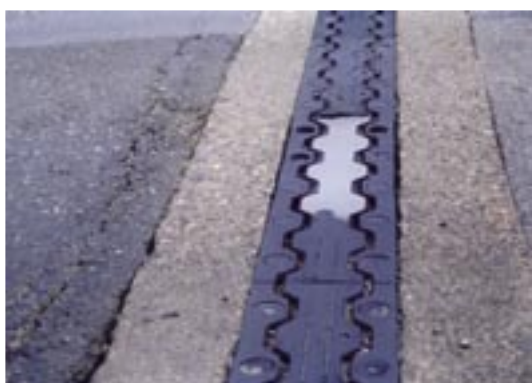
写真-23.5 伸縮装置のゴム材に欠損が生じた例
