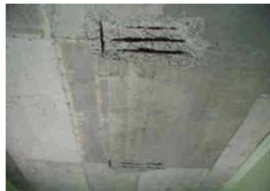
写真-7.12 床版に剥離・鉄筋露出を生じた例
