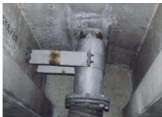
写真-5.4 メッキに錆が生じた例
