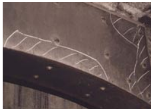
写真-10.2 主桁の補強鋼板こうきが生じた例 (注：うき部分はチョークでマーキングしている)
