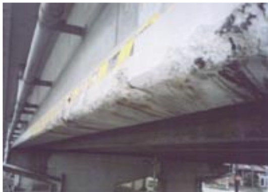
写真-7.7 欠損（衝突痕）を生じた例
