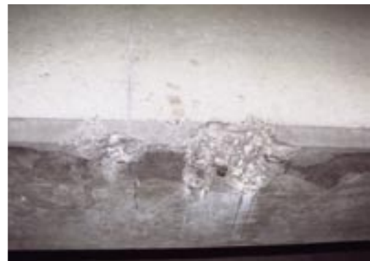
写真-7.8 欠損（衝突痕）を生じた例
