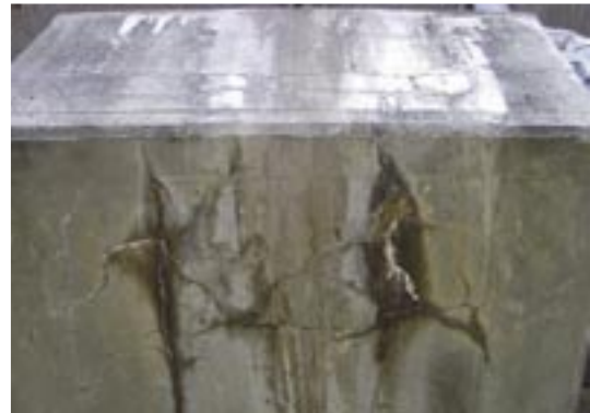
写真8.10 ひびわれ部から生じた例
