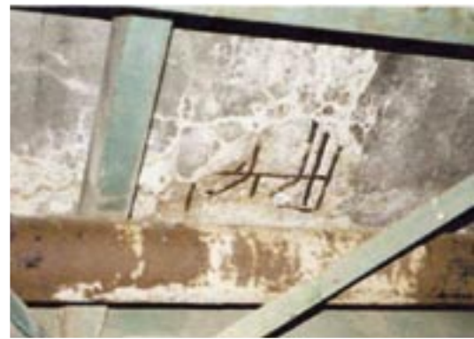
写真-11.8 床版下面のひびわれとコンクリートの剥離、鉄筋露出が生じた例
