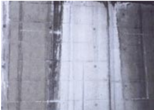
写真8.7 表面を伝う水によって析出物が発生した例
