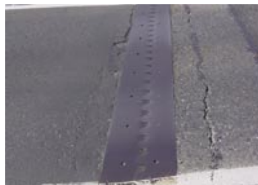
写真-13.6 伸縮装置の遊間が完全に閉じ、 舗装にひび割れが生じた例 (注：地震後に発見された損傷)
