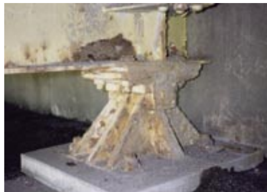
写真-16.8 支承アンカーボルトの腐食の例
