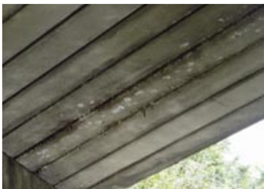
写真-8.3 床版留部から生じた例
