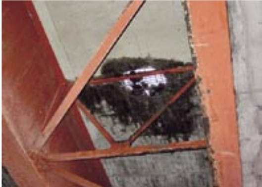
写真9.1 コンクリート塊が抜け落ちた例
