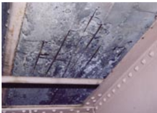
写真-7.11 床版に剥離・鉄筋露出を生じた例
