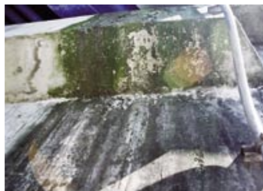
写真-17.6 コンクリート部材の表面を伝う水による汚れの例
