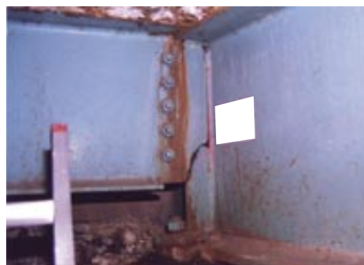
写真4.2 端横行で破断しているともみなせる程度に断裂した例 (注:亀裂に沿って赤くマーキングしている)
