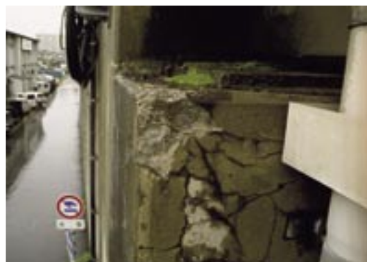
写真-6.8 ひびわれ以外にコンクリートの剥離を生じた例
