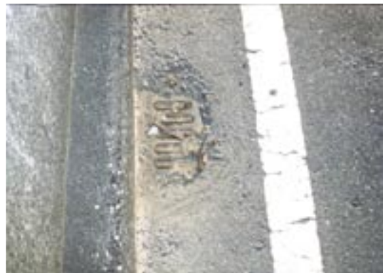
写真-24.2 排水柵に土砂詰りが生じた例
