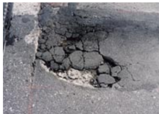
写真-15.2 舗装の陥没の例
