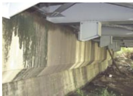
写真-19.8 コンクリート表面を伝う水によって発生した汚れの例
