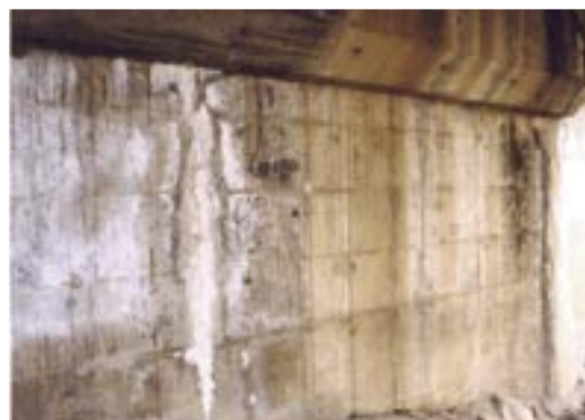
写真-8.4 橋台に生じた例
