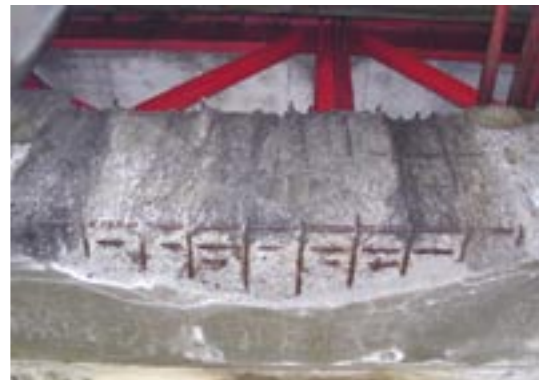
写真-7.10 露出した鉄筋が腐食している例
