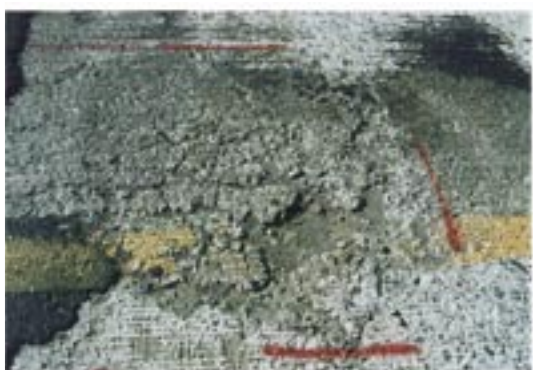
写真-15.3 床版上面のコンクリートの土砂化が生じた例 (注:舗装撤去している)
