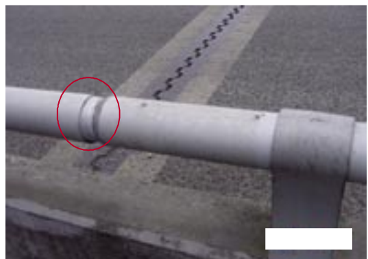
写真-13.12 防護柵の横梁の伸縮部が異常に広い状態の例 (注：地震後に発見された損傷)
