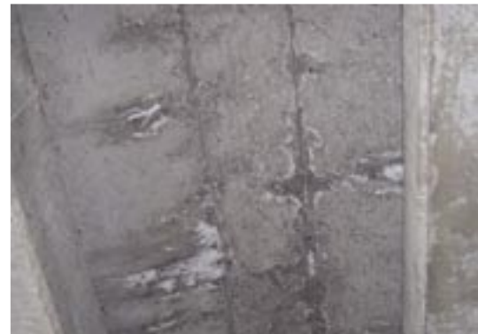
写真8.12 床版間詰部に生じた例
