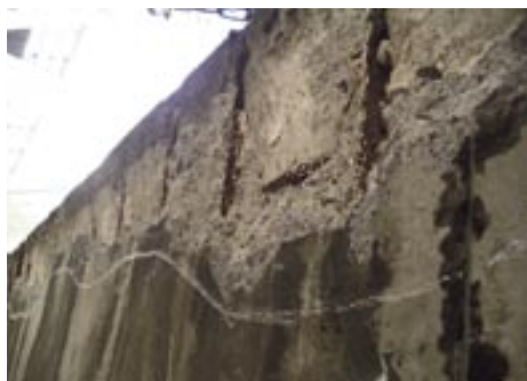
写真-7.6 剥離・鉄筋露出が生じた例
