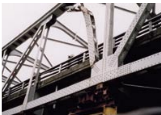
写真-4.7 斜材の破断と変形が生じた例
