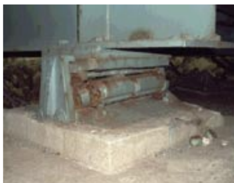
写真3.7 支承ローラーが脱落した例
