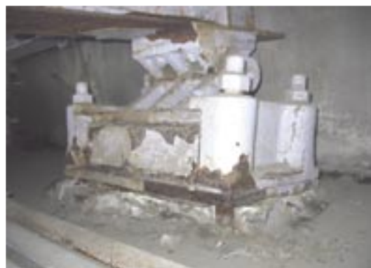
写真-16.2 荷重支持機能を損なわれている状態の例
