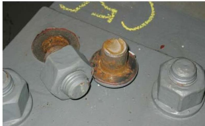
写真-5. 1. 52 破断したボルトの例
