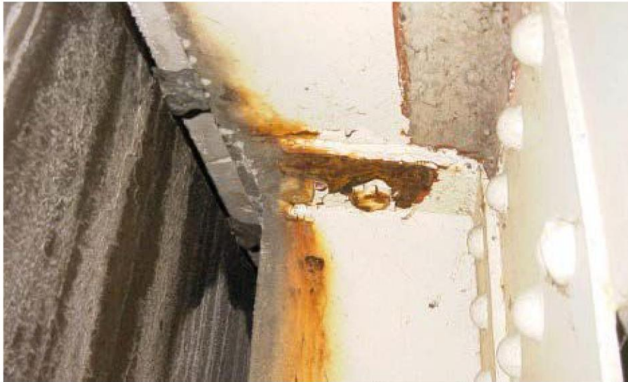
写真-5.1.16 鋼橋の腐食の診断における留意点
