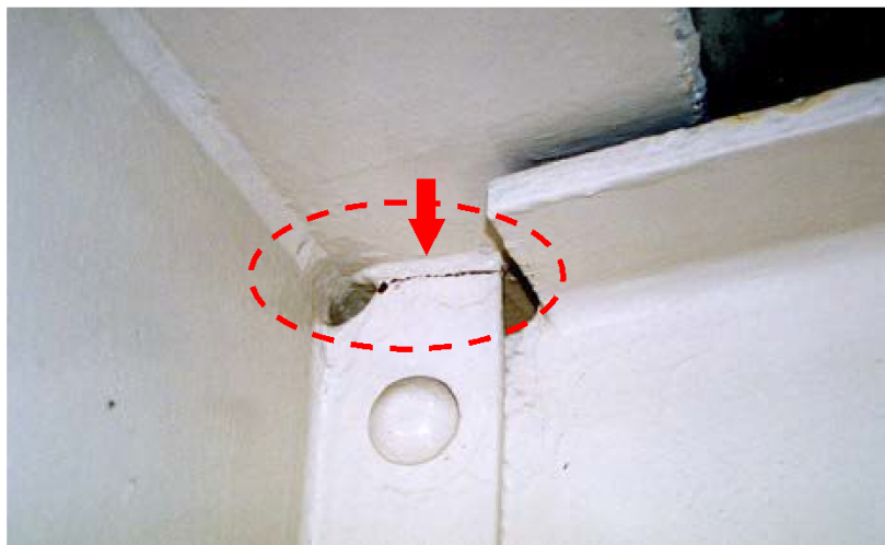
写真-5. 1. 37 鋼橋の亀裂の診断における留意点
