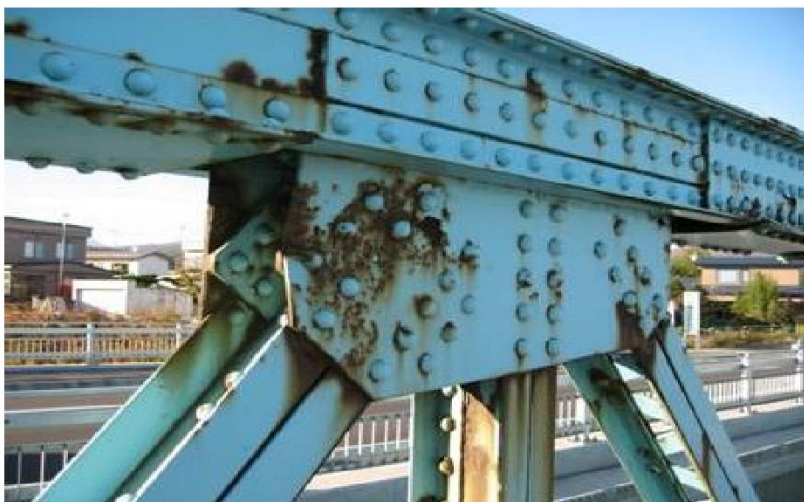
写真-5. 1. 28 鋼橋の腐食の診断における留意点
